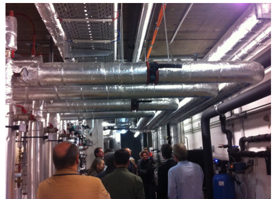
Bei der anschließenden Führung wurde die zentrale Kühlung wie Heizung besichtigt.
